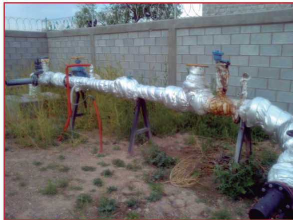
Ilustración 4.2 Protección contra heladas en múltiple de descarga de pozo profundo con medidor de velocidad, en la JMAS Aldama, Chihuahua
