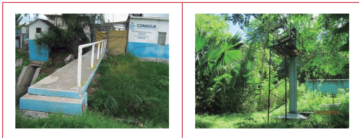
Ilustración 6.4 Izquierda pasarela para aforo, derecha sistema cable canastilla
