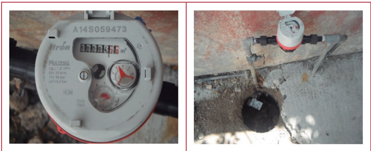
Ilustración 11.10 Medidor electromagnético domiciliario
