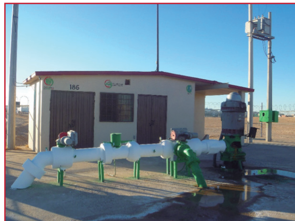
Ilustración 4.3 Protección contra heladas en múltiple de descarga de pozo profundo con medidor de electromagnético, en la JMAS Juárez, Chihuahua
