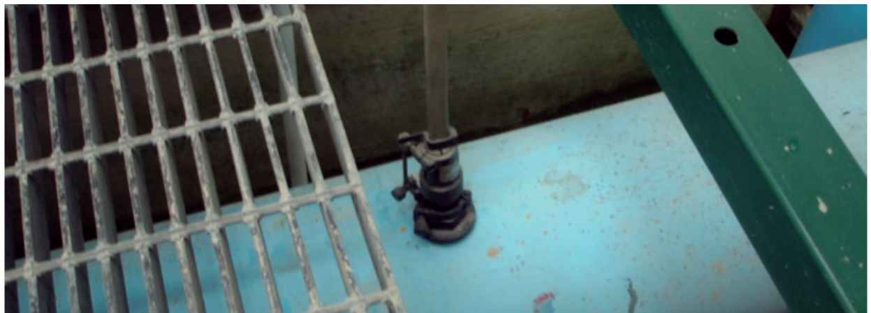
Ilustración 7.11 Conexión de tubo Pitot a la línea a presión
