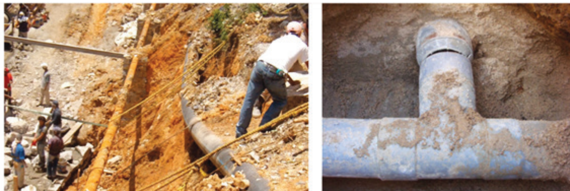
Ilustración 8.2 Daño en tuberías
