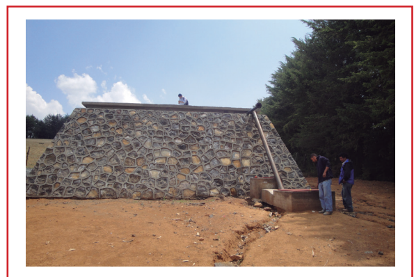
Ilustración 7.1 Tanque superficial de mampostería
