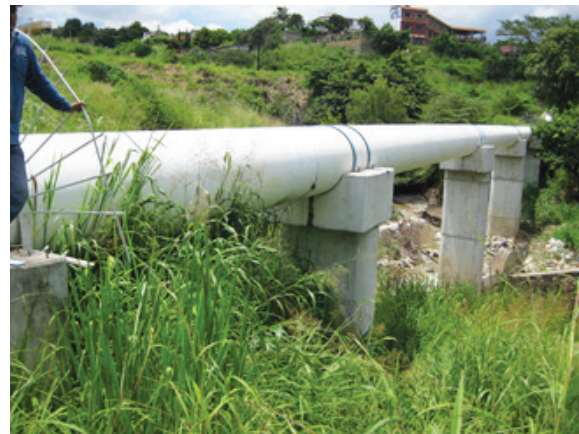
b) Tubería soportada por estructura
