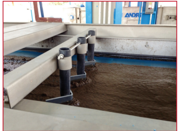
Ilustración 2.20 Espesador de bandas en funcionamiento se observan los arados y la capa de lodo sobre la banda
