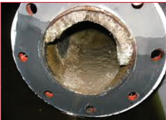
Ilustración 4.23 Deposición de estruvita en tubería
