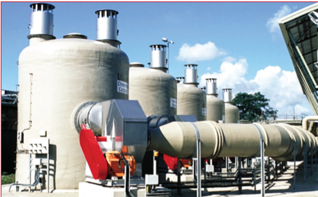
Ilustración 4.28 Tratamiento del sulfuro de hidrógeno
