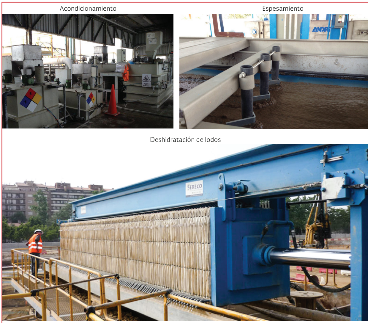
Ilustración 1.1 Ejemplos de acondicionamiento (parte superior izquierda), espesamiento (parte superior derecha), y equipo de deshidratación (parte inferior)
