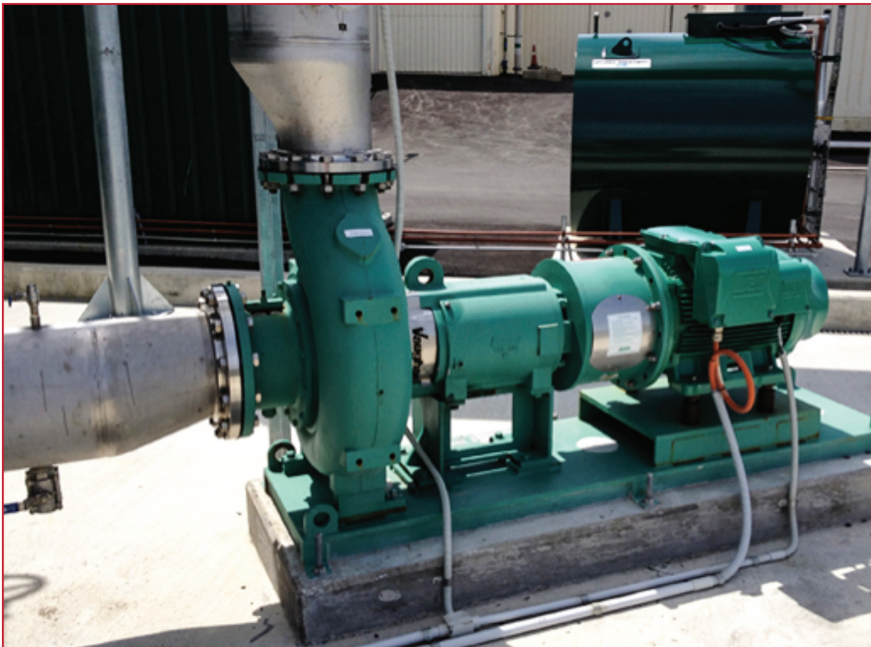
Ilustración 4.8 Sistema de bombeo para el mezclado del reactor
