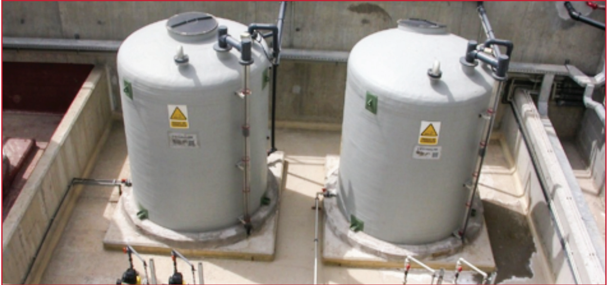
Ilustración 2.7 Tanque de almacenamiento de cloruro férrico
