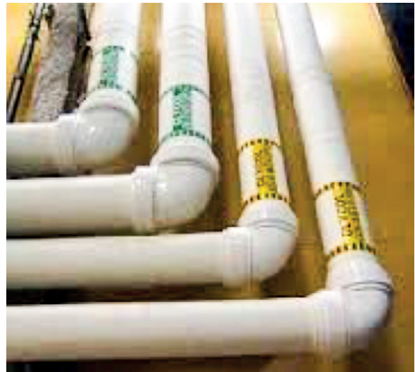
Ilustración 4.5 Tuberías de conducción
