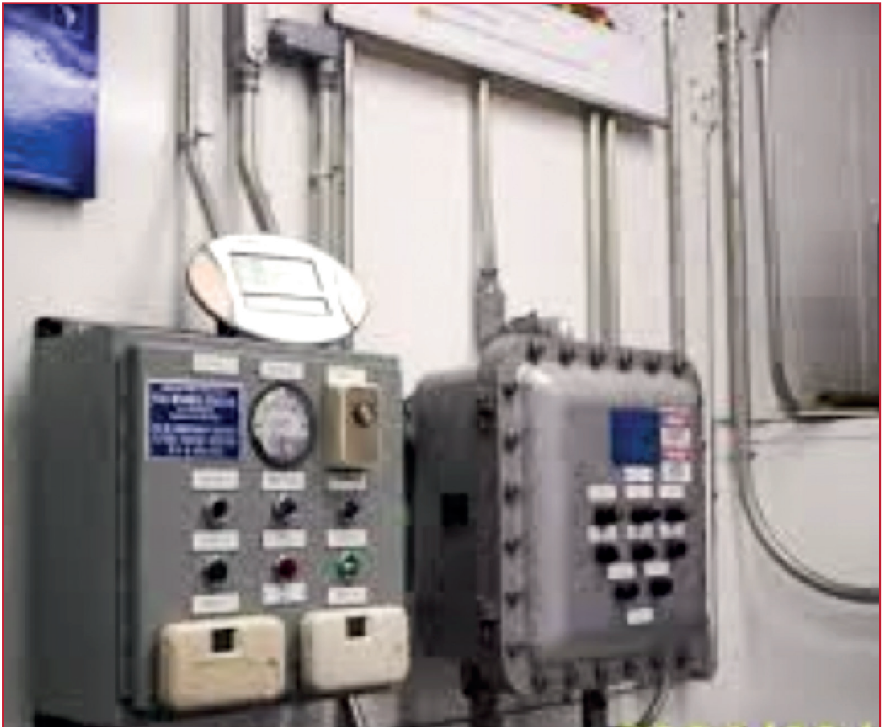
Ilustración 4.25 Instalaciones eléctricas con carcasa.
