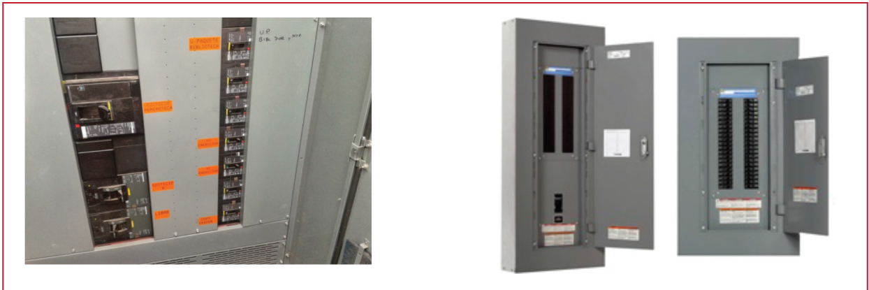
Ilustración 4.5 Tableros de distribución y alumbrado
