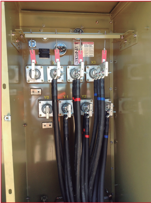
Ilustración 2.12 Cables y terminales en buen estado
