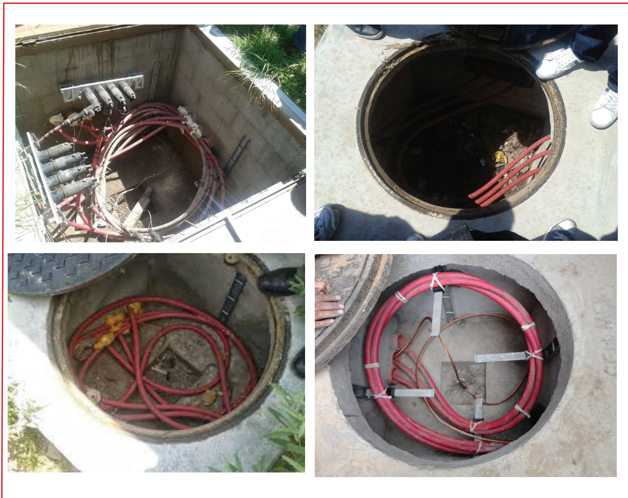
Ilustración 4.13 Registro de instalación eléctrica
