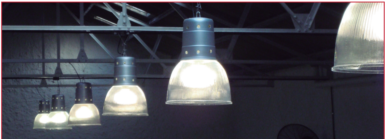
Ilustración 4.23 Luminaria de emergencia
