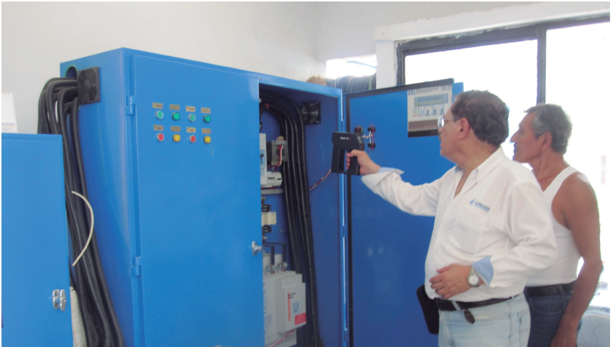
Ilustración 4.3 Medición puntos calientes de tableros
