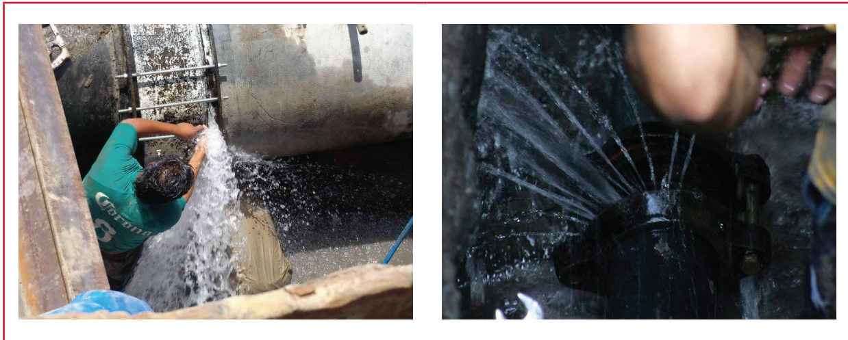
Ilustración 1.7 Fuga en una junta entre tubos (ODAPAS, Nezahualcoyotl)
