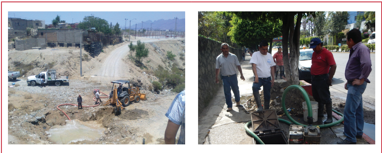
Ilustración 3.8 Equipos de bombeo
