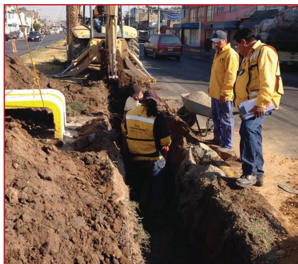
Ilustración 1.49 Excavación de zanja por personal de ODAPAS Nezahualcoyotl
