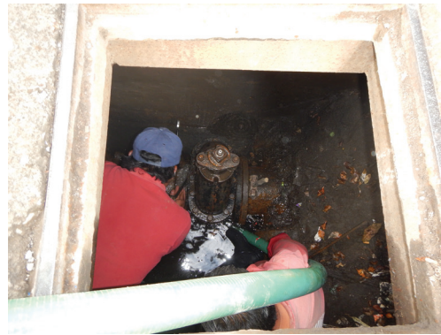
c) Limpieza de la válvula
