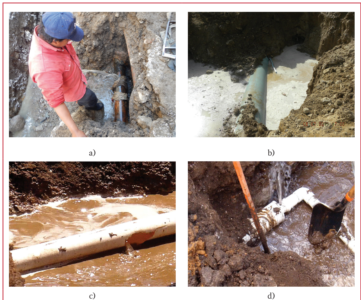
Ilustración 1.3 Ejemplo de fugas en una tubería
