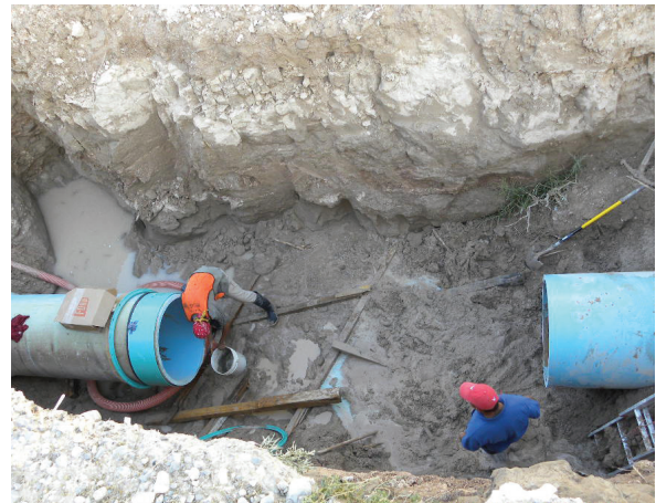
b) Corte de tramo de tubería dañado
