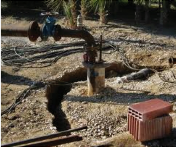
Ilustración 2.1 Grieta alrededor de un pozo por licuación
