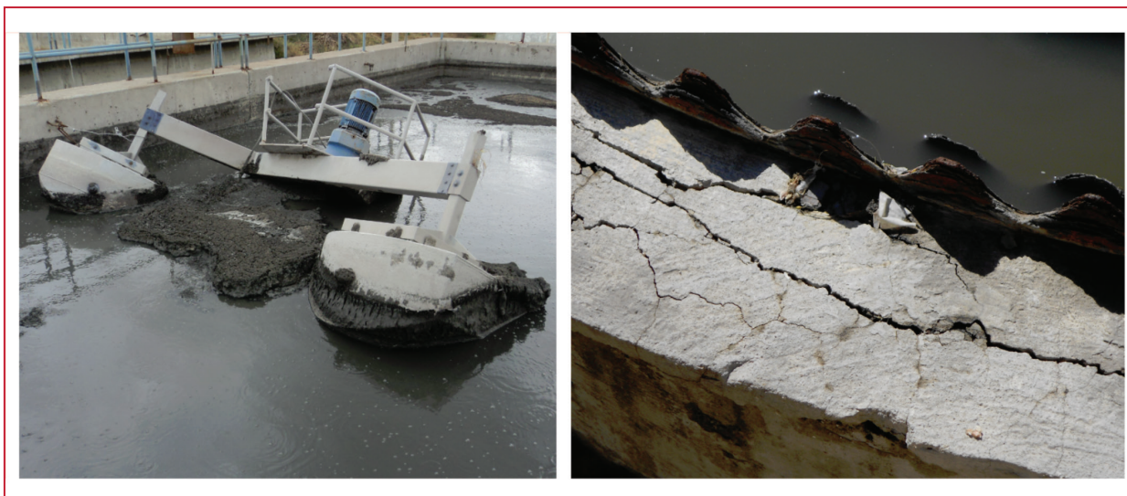
Ilustración 2.4 Daños estructurales a tanques de procesos
