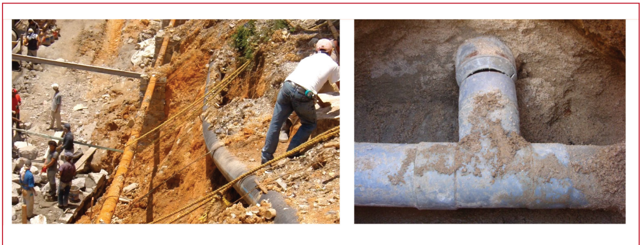
Ilustración 2.2 Daño en tuberías
