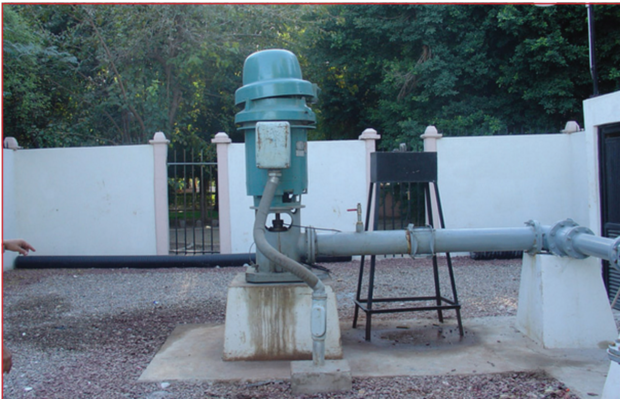
Ilustración 4.1 Equipo de bombeo con eficiencia baja
