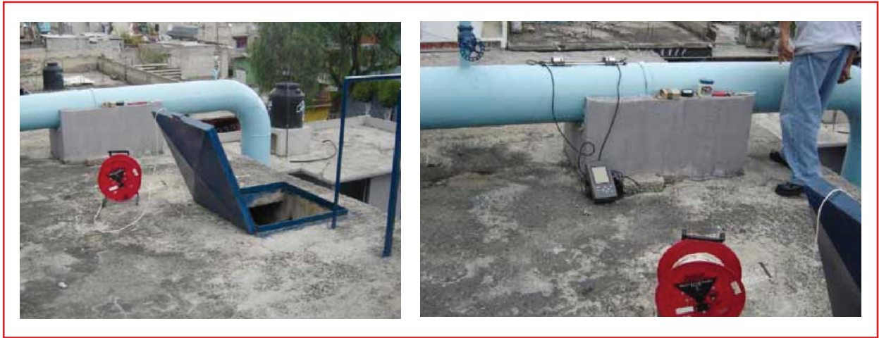
Ilustración 1.22 Medición del nivel dinámico de succión en cárcamos de bombeo
