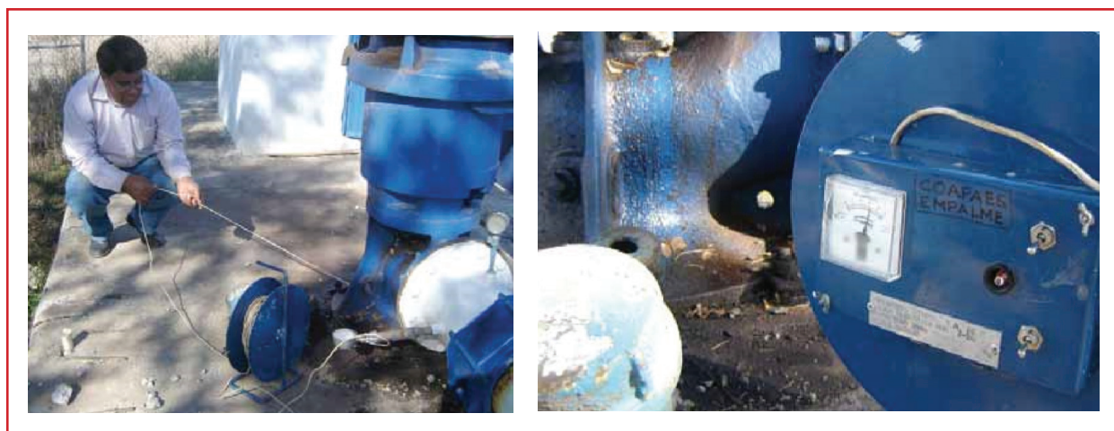
Ilustración 1.21 Medición del nivel dinámico de succión en cárcamos de bombeo
