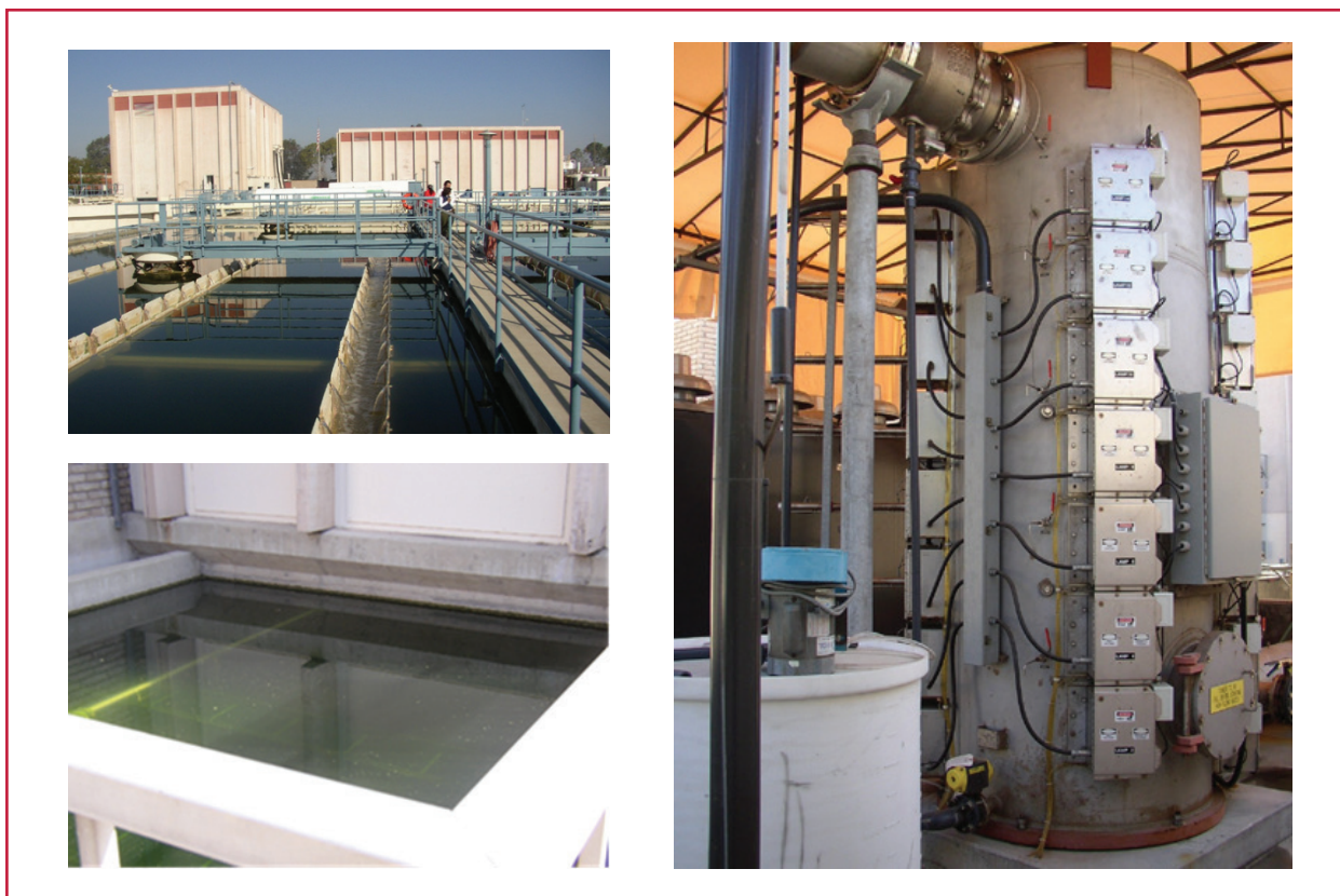
Ilustración 5.24 Procesos unitarios de la planta de tratamiento de Orange: a) módulo de sedimentación, b) filtros rápidos, c) módulo de tratamiento con luz UV
