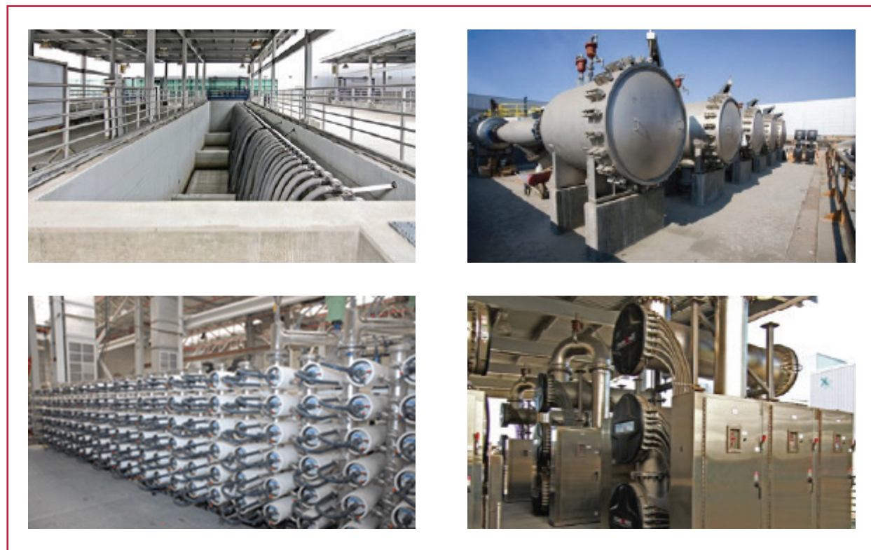
Ilustración 5.26 Módulos de la planta de tratamiento avanzado de Orange: a) módulo de microfiltración (filtros de cartucho), c) ósmosis inversa, d) oxidación avanzada y desinfección
