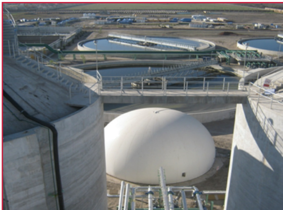
Ilustración 14.7 Tanque para almacenamiento de biogás. Cortesía CONAGUA
