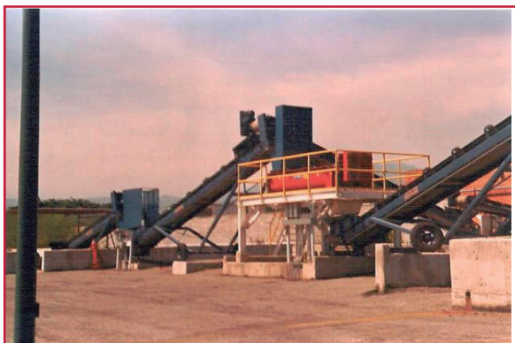
Ilustración 9.13 Mezclador estático y bandas transportadoras para los materiales y mezcla
