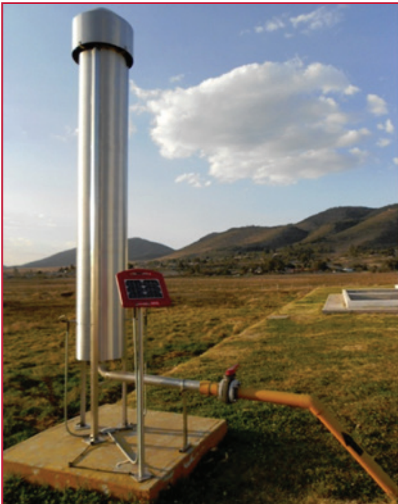
Ilustración 14.6 Quemador de biogás. Cortesía Conagua
