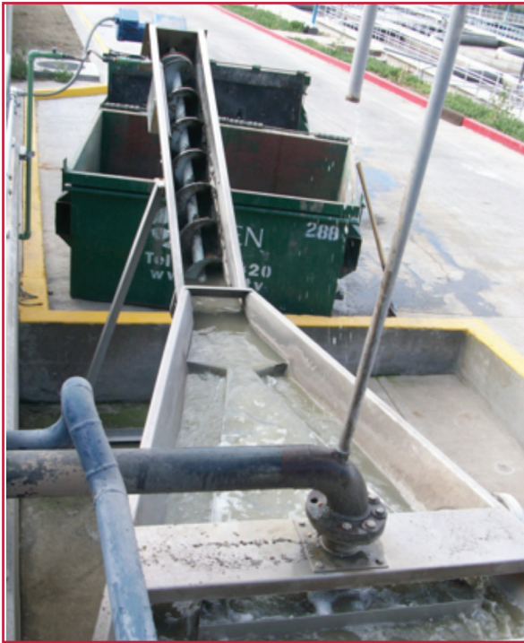
Ilustración 5.25 Tornillo lavador de arena, PTAR Tijuana B.C.
