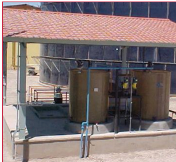
Ilustración 6.6 Tanques para la preparación de soluciones
