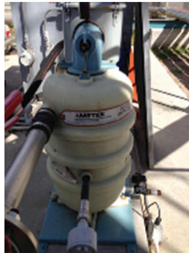
Ilustración 14.3 Deshumidificador de biogás
