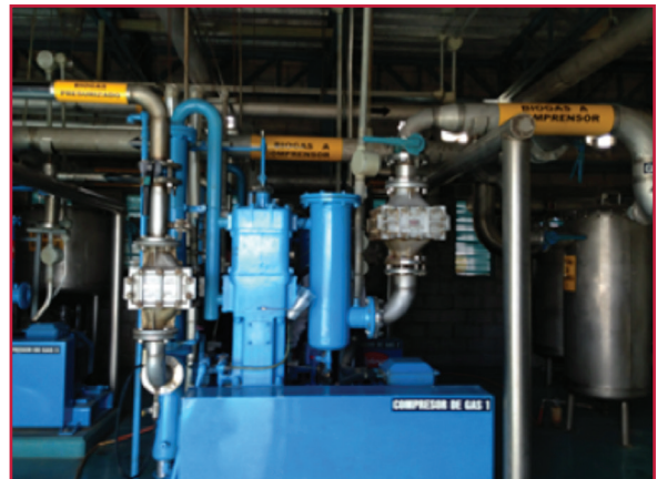
Ilustración 14.8 Sistema de compresión de biogás. Cortesía PTAR de León, Guanajuato
