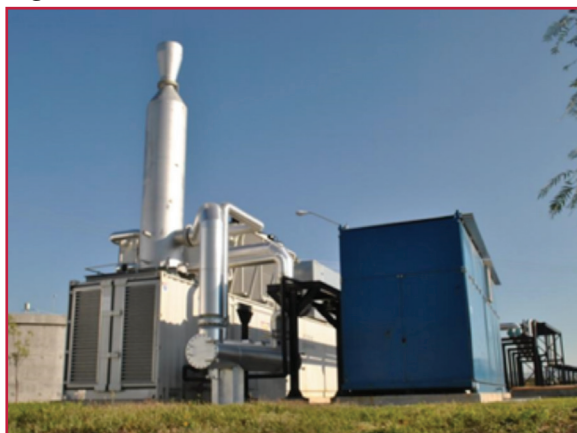
Ilustración 14.9 Unidad de cogeneración. Cortesía de Conagua
