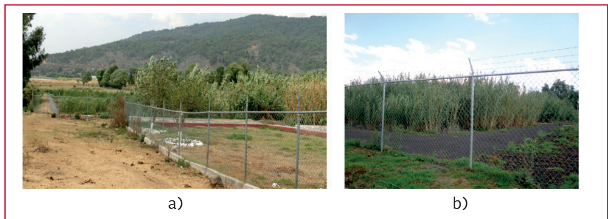
Ilustración 2.20 Uso de mallas ciclónicas para protección de las instalaciones
