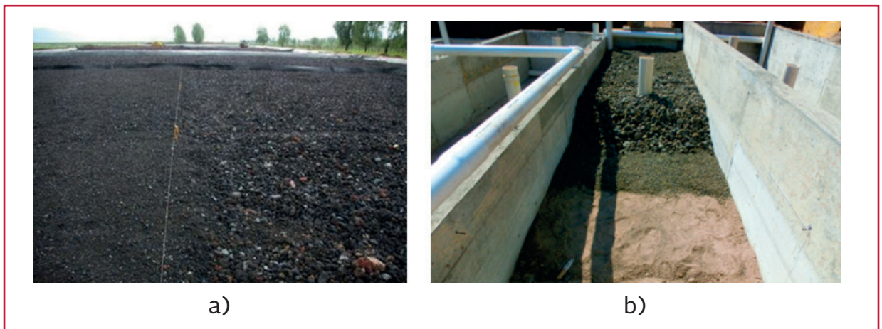
Ilustración 2.32 Colocación del medio filtrante. a) grava con diámetro de 1 a 1.5 cm colocada sobre grava con diámetros de 2 a 3 cm, b) Colocación de diversas capas de grava (arcilla en el fondo, y grava de 2 a 5 cm en la superficie)
