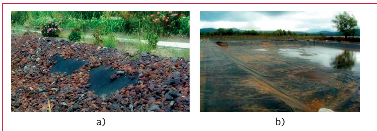
Ilustración 2.23 Impermeabilización mediante geomembranas. a) Con protección contra el sol con de grava, b) antes del relleno con grava
