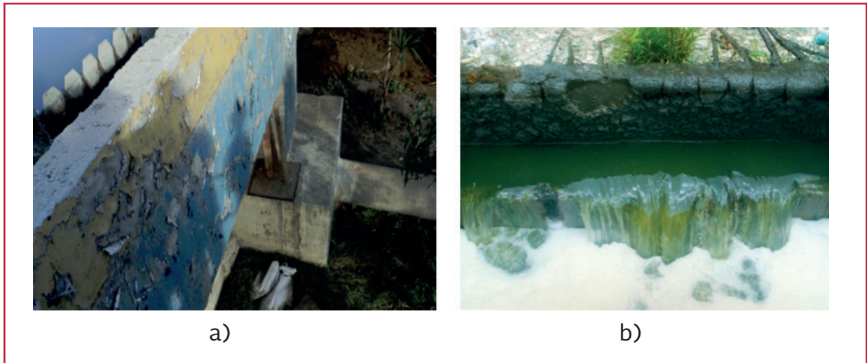
Ilustración 2.9 Cementos de baja calidad. a) Paredes de un registro de llegada, b) Vertedor rectangular
