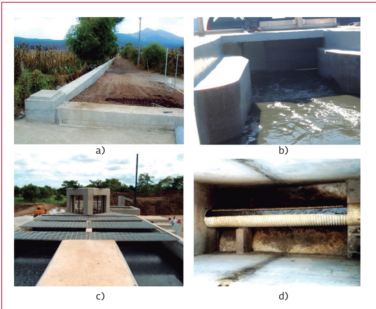
Ilustración 2.6 Tuberías de llegada y control de caudal en la entrada del humedal: a) Colector encofrado, b) Caja de llegada, c) válvula de control, d) tubería en mediacaña
