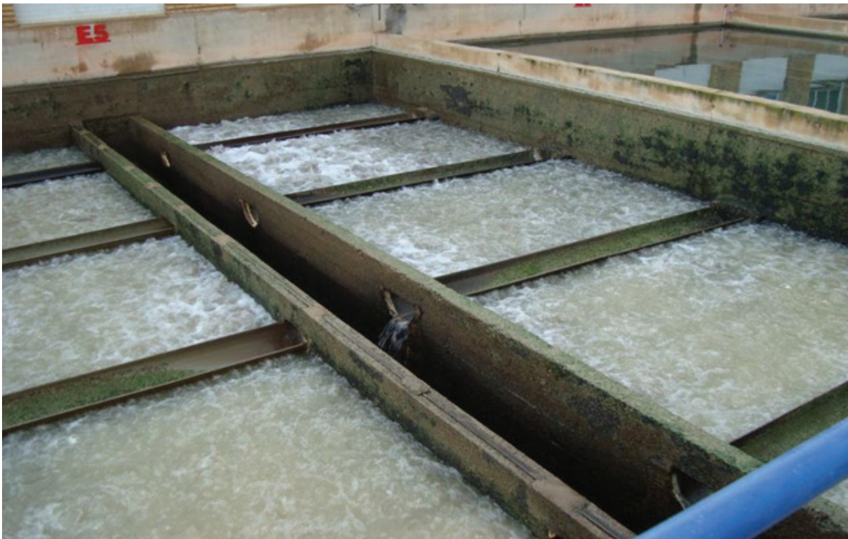
Ilustración 6.10 Lecho de arena de un filtro en retrolavado y canaleta
