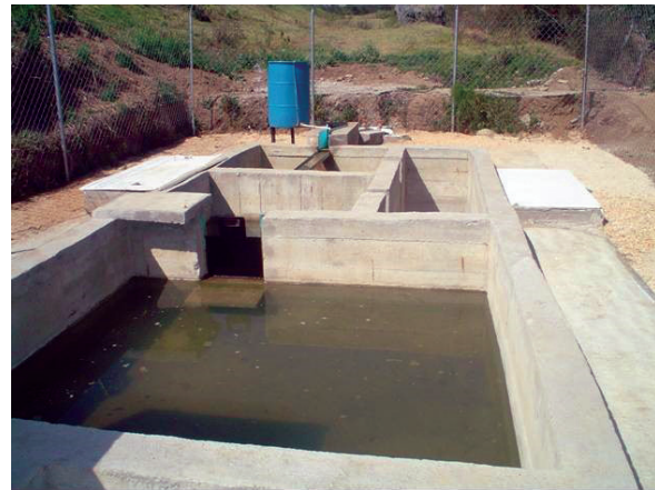
Ilustración 3.7 Filtro lento de arena en comunidad rural
