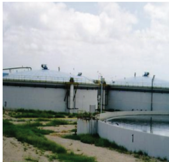
Ilustración 3.9 Reactores anaerobios de la planta de tratamiento
