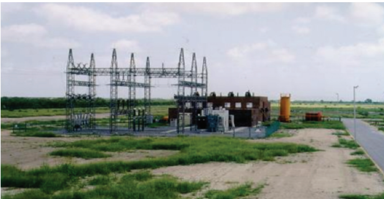
Ilustración 3.11 Vista general de la planta de cogeneración y limpieza de biogás
