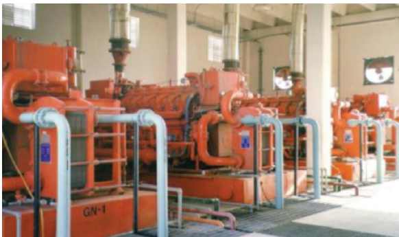
Ilustración 3.12 Unidades de cogeneración
