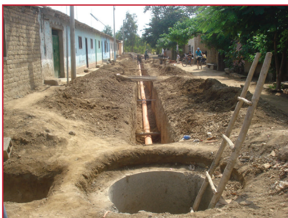
Ilustración 2.11 Tubería para alcantarillado sanitario
