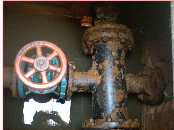
Ilustración 2.9 Crucero con válvula de seccionamiento
