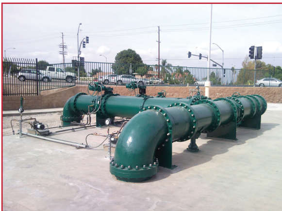
Ilustración 2.10 Estación de rebombeo (recuperado de www.akmce.com )
