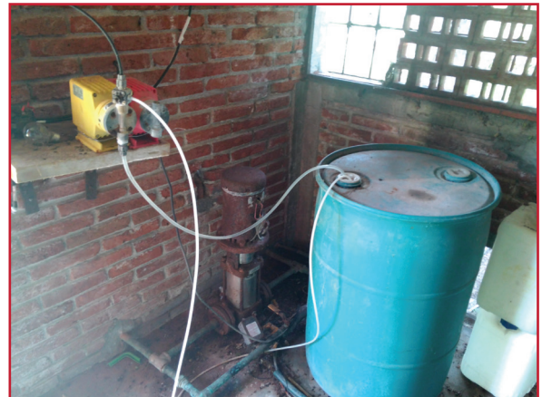
Ilustración 2.7 Sistema de cloración (IMTA, 2013)
