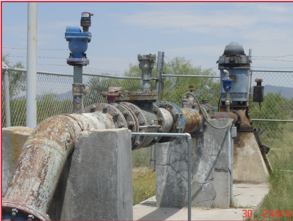
Ilustración 2.6 Pozo Sáuz No. 31 (IMTA, 2011)
