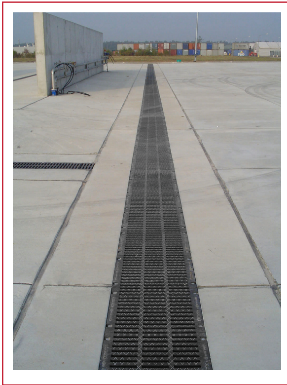
Ilustración 6.38 Rejilla de ingreso en coladera de piso
