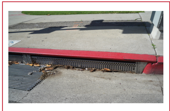
Ilustración 6.40 Coladera combinada desfasada
