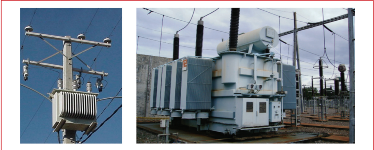
Ilustración 2.17 Transformador de distribución y transformador de potencia resistencia anti-condensación
