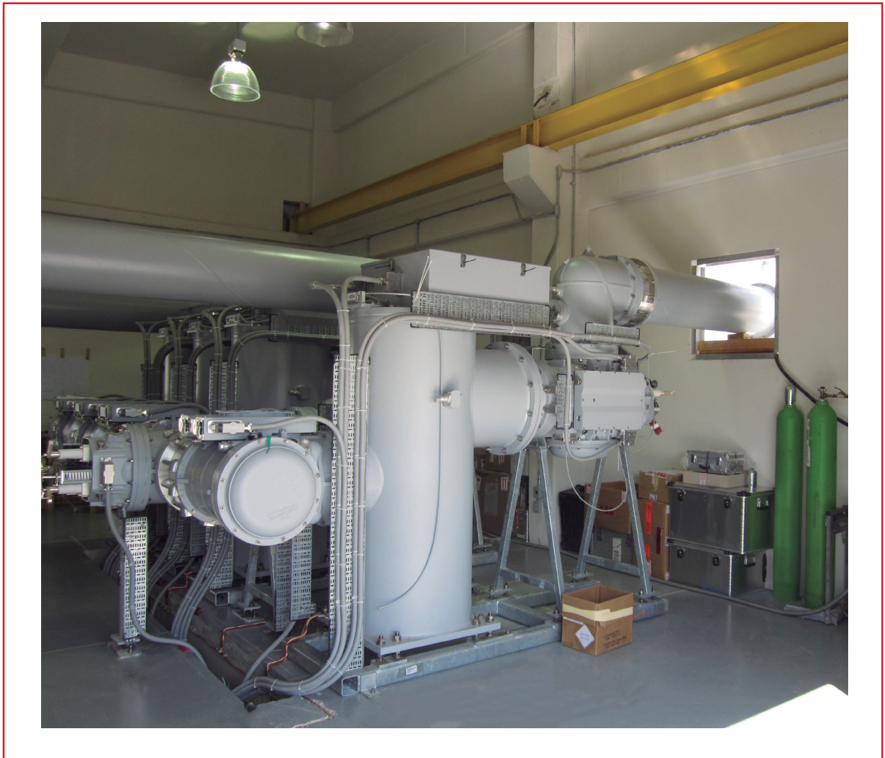
Primera subestación en SF 6 ubicada en el Realito
