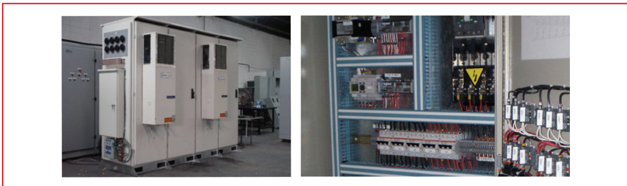
Ilustración 2.30 Tableros de media y baja tensión
