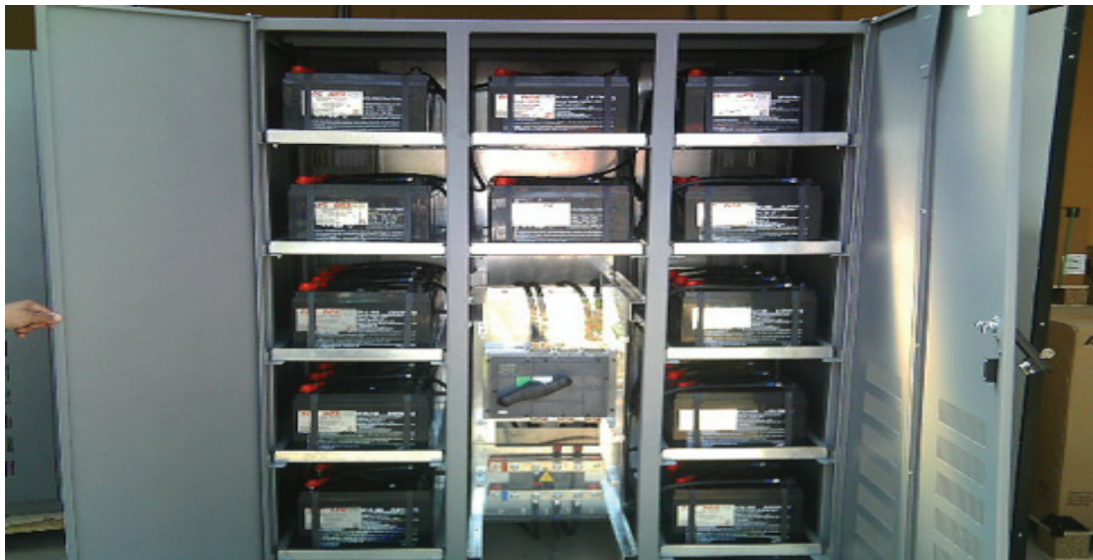
Ilustración 2.43 Banco de baterías
