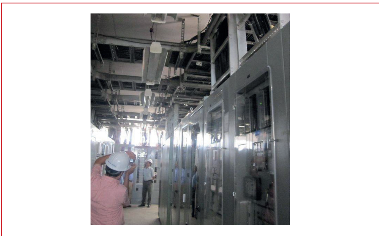
Ilustración 2.31 Tableros de media tensión
