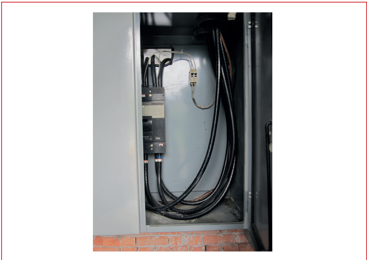
Ilustración 2.34 Conductores de interruptor principal
