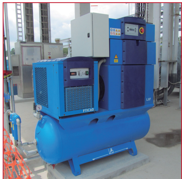
Ilustración 11.1 Compresor de planta de tratamiento
