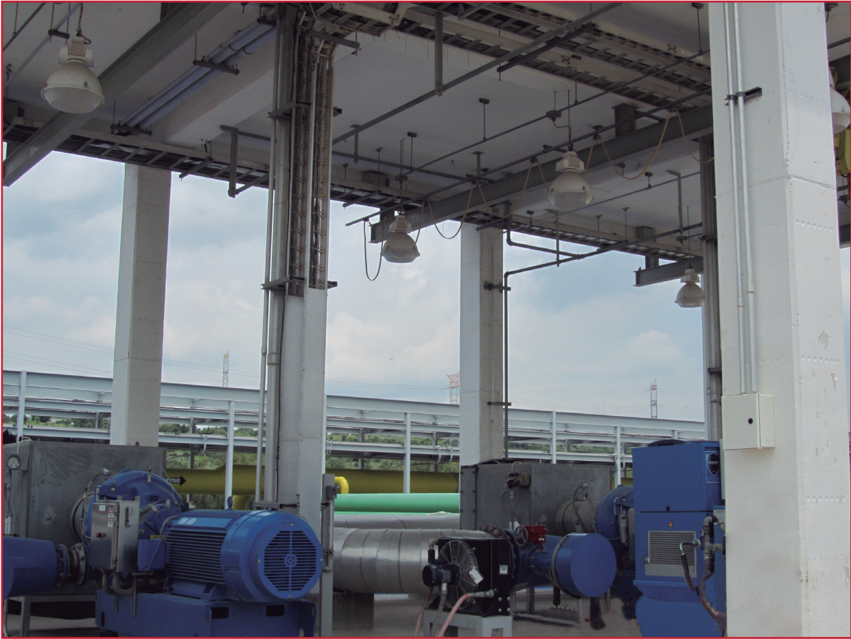
Ilustración 11.15 Cuarto de sopladores
