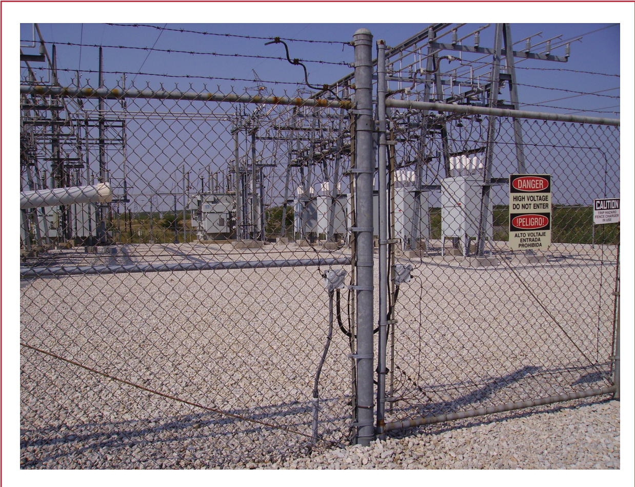
Ilustración 3.4 Cercado de subestación eléctrica
