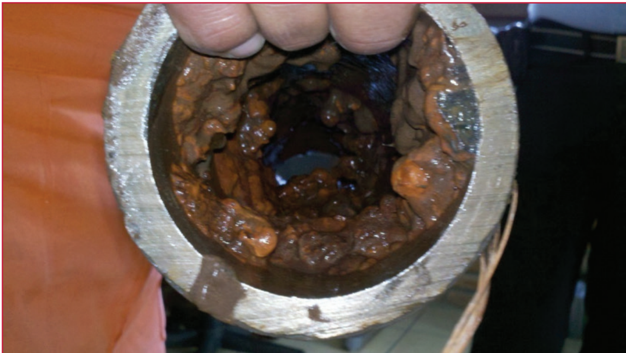
Ilustración 3.6 Condiciones de las tuberías de hierro galvanizado de 4 pulgadas, con más de 35 años de edad (Albornoz y Serra, 2011)
