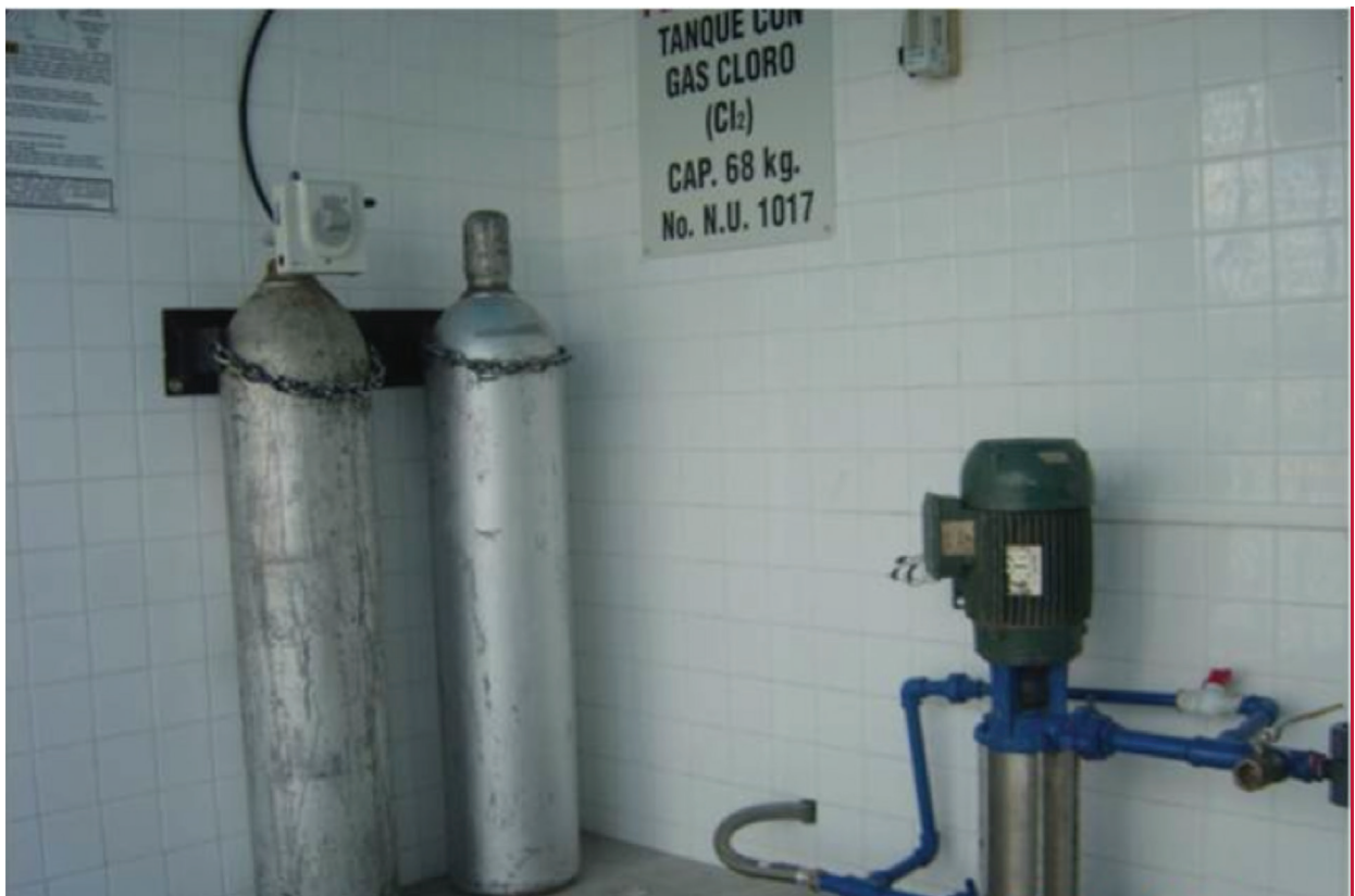
Ilustración 4.2 Sistema de cloración por medio de gas
