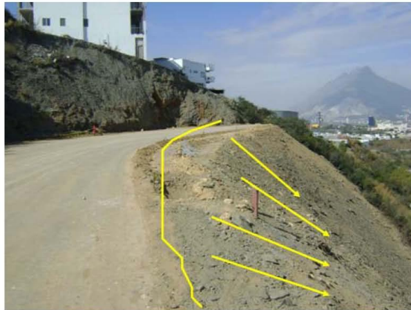
Fotografía 7.5.7.2.2.1. En este sitio la principal causa probable de inestabilidad se debe al material de corte colocado a volteo. En esta zona se tiene un espesor aproximado de 60 cm de material suelto el cual se colocó sobre la roca que aflora de forma natural en el talud.
