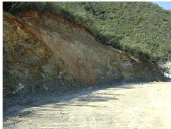
Fotografías 7.5.7.2.6 y 7.5.7.2.6a. Taludes en vialidad del fraccionamiento.
