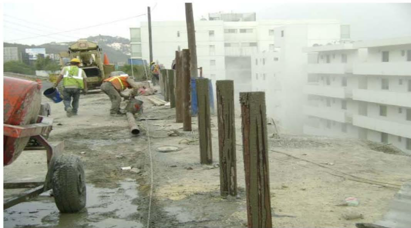
Figura 7.3a. Colocación de micro pilotes sobre la Avenida San Francisco, flanco norte de la Loma Larga.
