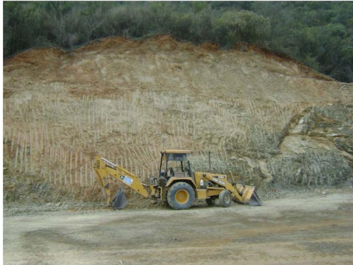
Fotografía 7.5.7.2.6.1. Talud recostado en el fraccionamiento.
