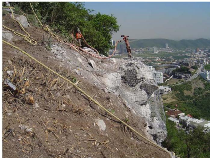
Fotografías 7.9a, 7.9b y 7.9c. Después de la demolición con martillo neumático y aplicación de productos químicos expansivos.
