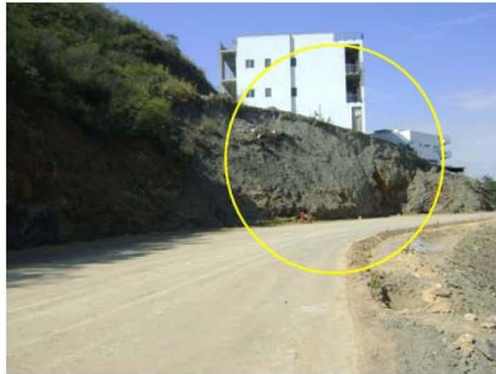
Fotografía 7.5.7.2.1. Talud ubicado entre los límites de la propiedad. Colinda con un edificio multifamiliar a 6 u 8 metros, aproximadamente. Cuenta con un descalzamiento importante en el pie (fotografía siguiente), lo cual lo vuelve inestable y susceptible a algún deslizamiento, aunado a un gran intemperismo.
