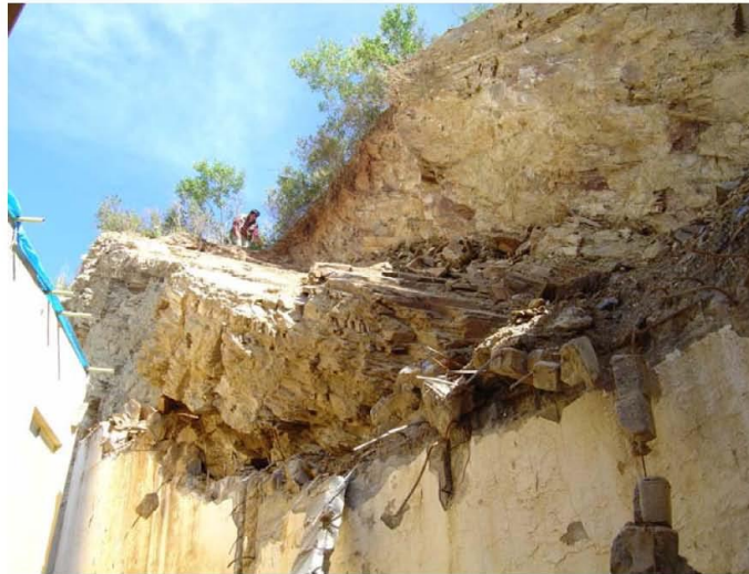
Fotografía 7.7d. Vista del talud que se deslizó sobre la casa habitación en el Fraccionamiento Bosques del Campestre, San Pedro Garza García, N.L.
