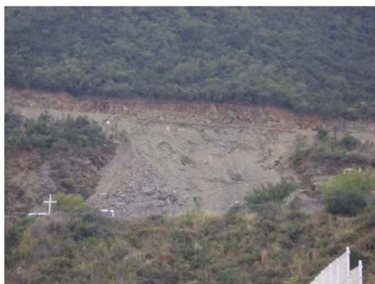
Fotografía 7.5.7.2.7.1a. La edificación de la iglesia se encuentra prácticamente en frente del corte del talud existente.
