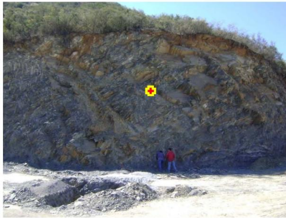
Fotografía 7.5.4b. Intemperismo severo y fracturamiento, se observa en el talud 0+000. La opción más viable como medida de mitigación es una línea de anclaje (✚).
