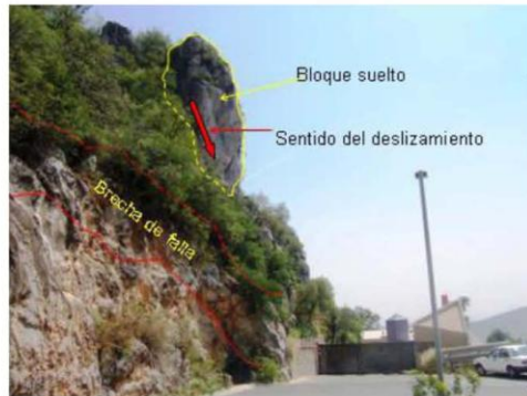
Fotografía 5.1.6a. La posición vertical, dimensión y fracturamiento del bloque, así como el grado de erosión e intemperismo en la base y la inclinación del talud son clara evidencia de la inestabilidad y alto riesgo.
