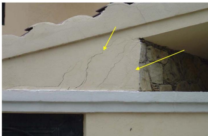
Fotografía 7.7a. Fracturas producto del empuje del bloque sobre la casa.
