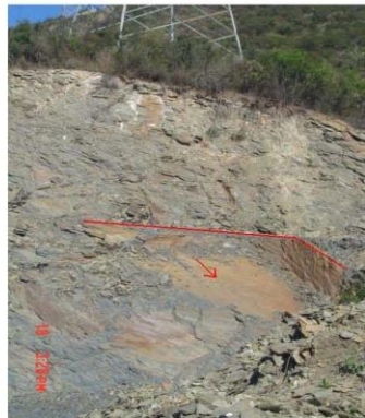
Fotografía 5.1.6b. Ejemplo de un desprendimiento de bloque por falla plana.
