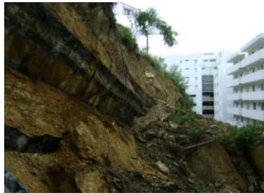
Fotografía 3.2.2. Daños generados por deslizamiento del talud en edificio Santa Fe I, después de las lluvias torrenciales que azotaron la ciudad de Monterrey y su área metropolitana los días 24 y 25 de Septiembre del 2010.
