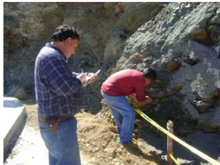
Fotografía 7.5.4a. En esta imagen se está trabajando en el talud bajo el edificio, en el cual se realizan actividades como toma de datos estructurales del macizo rocoso para determinar el grado de fracturamiento de éste, y así poder determinar su grado de estabilidad.
