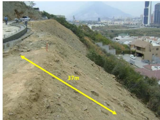
Fotografía 7.5.7.2.2. Material suelto producto del corte quedó sobrepuesto en el cuerpo del talud. El mayor problema para este caso, serían los arrastres de finos y material debido a la saturación del terreno en precipitaciones de consideración. Tales arrastres afectarían en primera instancia a los predios vecinos.
